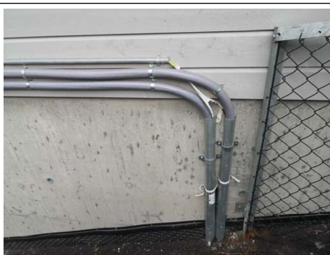
Enden på øvre Andedam-garasjerekke, ved stikkveien. Manglende beskyttelse av ledningen.
