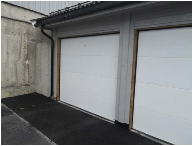
Dette er fra garasjerekke ved idrettsplassen, innerste garasje ved nr 80. Ved kraftig regn trenger vann inn i garasjen her.
