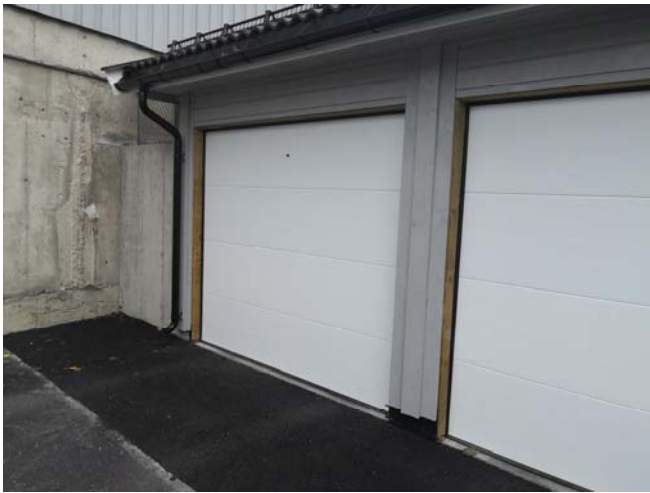
Dette er fra garasjerekke ved idrettsplassen, innerste garasje ved nr 80. Ved kraftig regn trenger vann inn i garasjen her.
