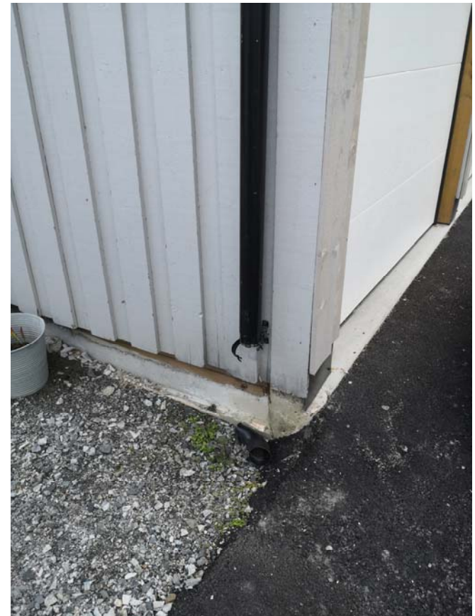
Dette er avløpet ved garasjerekka mot AM Knutsens gate. Sett fra 1. Strøm terrasse 40.
