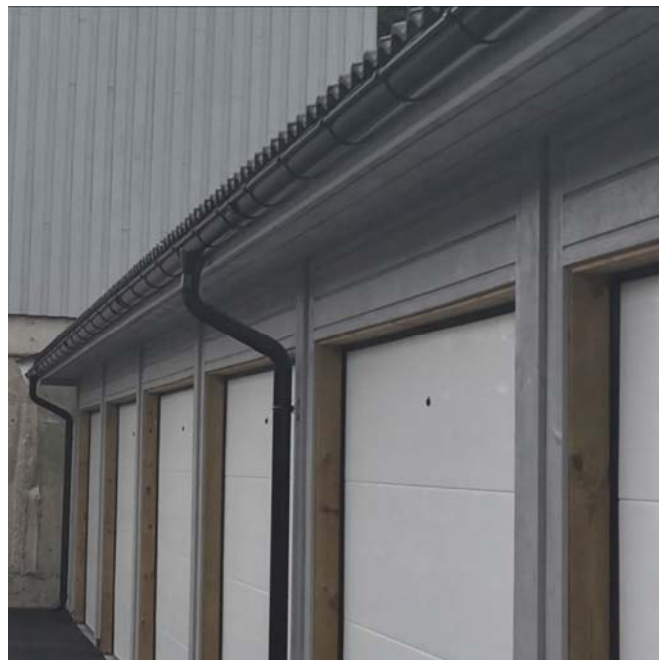
Bord i garasjeramme er ikke gråmalte som resten av garasjen.
