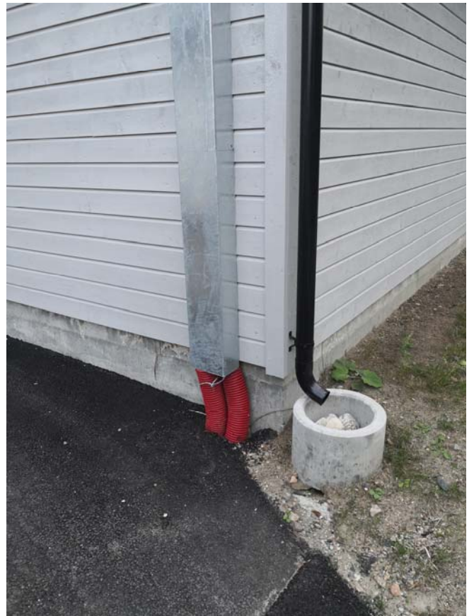
Her mangler beslag på strømkabler, nederst. Fra nedre garasjerekke nærmest idrettsplassen.
