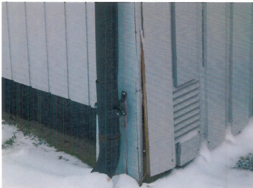
Bilde 4 viser skadet kledning/hjørneekasse på garasjerekke
